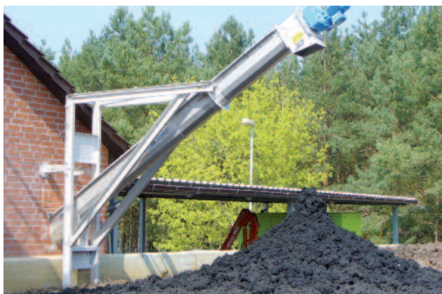
Шнековый транспортер HUBER ROTAMAT® Ro 8t, установленный после системы обезвоживания осадка
