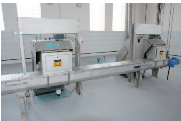
Две установленные параллельно решетки с отводом отбросов на один шнековый транспортер
