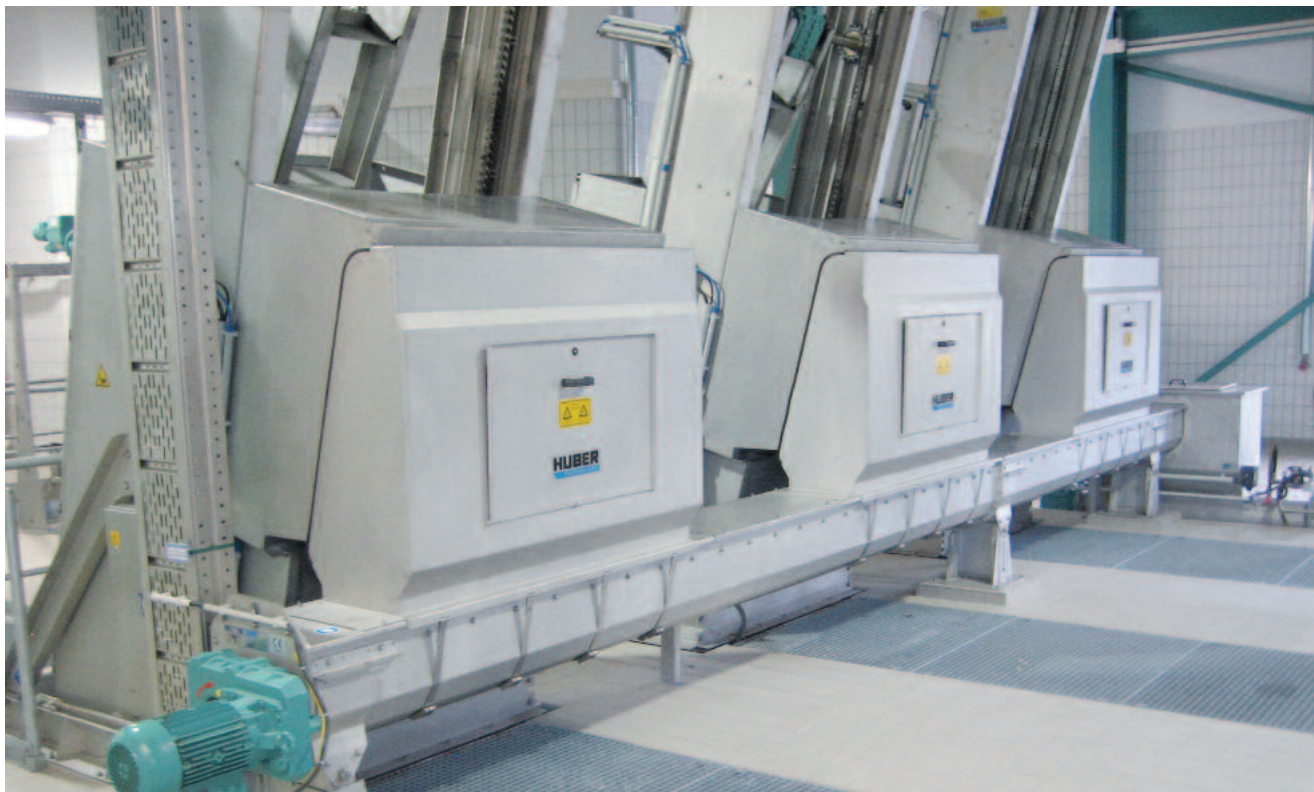
Три решетки с отводом отбросов на шнековый транспортер ROTAMAT® Ro 8t
